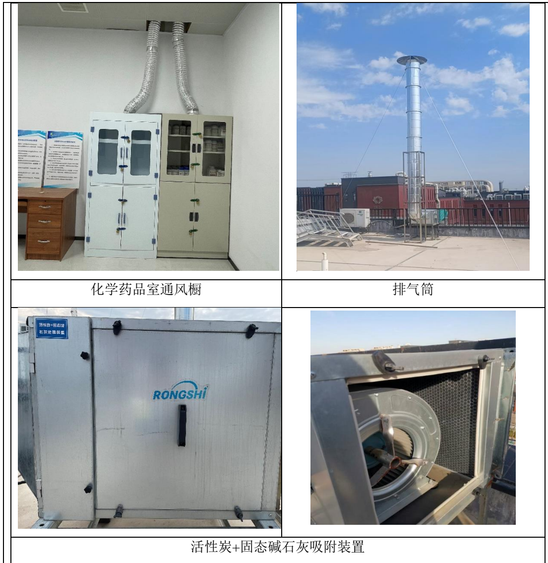
图 3-1 废气处理和排放设施
